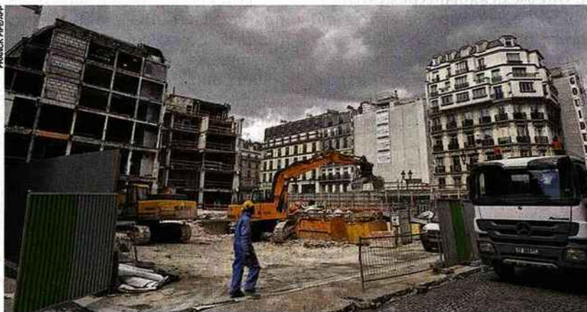
Destruction des anciens ateliers de la "Samaritaine", contre l'avis de la CVP.
